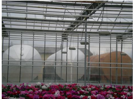
Bild 1: Öltanks und Pufferspeicher
